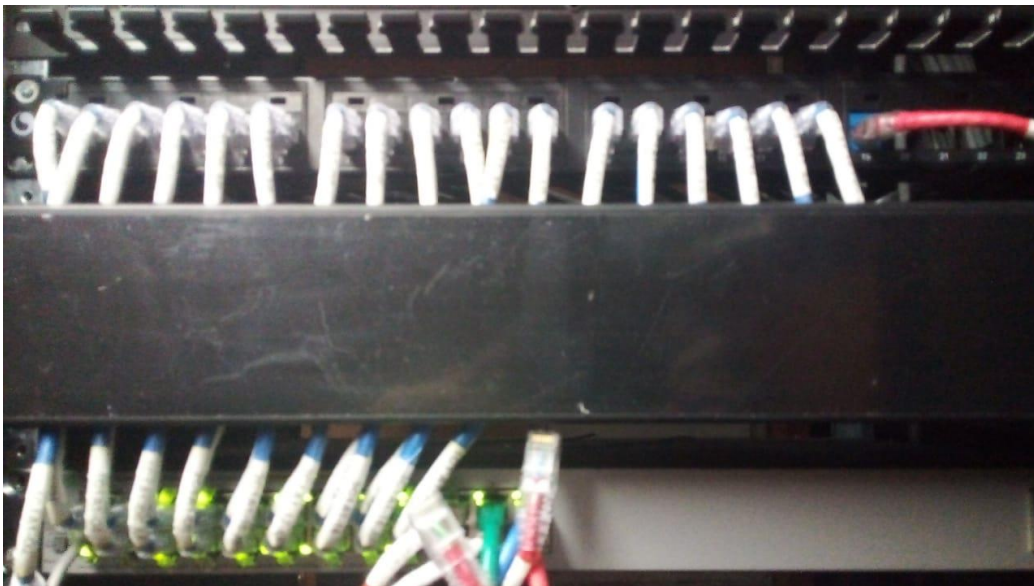
Ilustración 58. Cableado Sede Los Olivos. Fuente: Dirección de Sistemas de Información de Sede.
